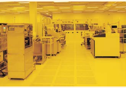
クリーンルーム
