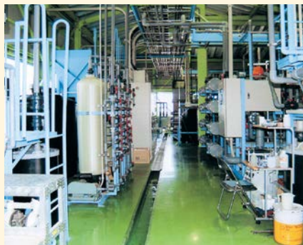
公害防止設備
